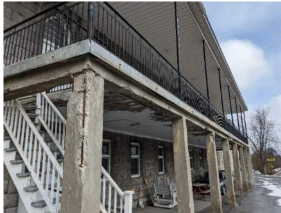
Photo 4: Dégradation avancée de la structure de béton
